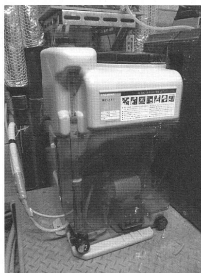
写真5 自動塩素注入装置
