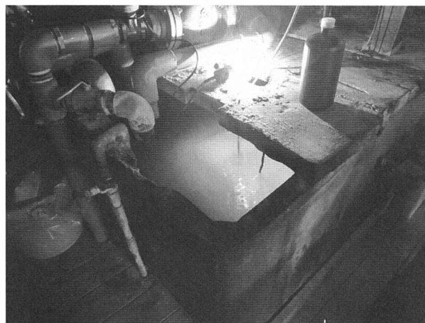
写真4 公衆浴場の調整箱
