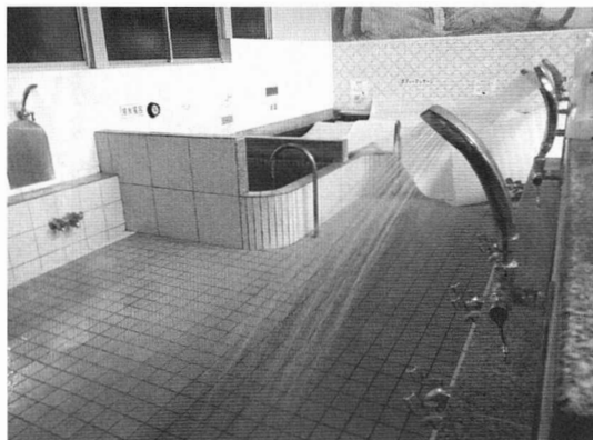
写真6 放水中のシャワー水
